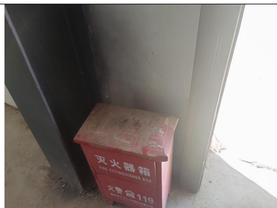
生产车间内设置的消防器材
